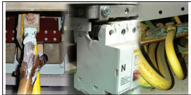
Abb. 16: Typische Fehler, die durch Niedrohmmessungen verhindert werden können
